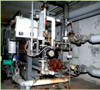
Vor der Modernisierung mit im Laufe der Zeit teilweise kleinen regelungstechnischen Anpassungen – Anlagenalter ca. 22 Jahre
